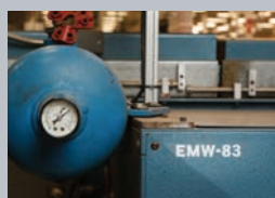
Identificação de equipamentos
